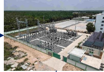
Trạm (110/22kV) tại KCN
