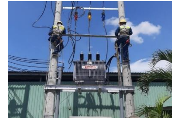
Trạm hạ áp (22/0,4kV)
