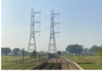
Đường dây 500kV
